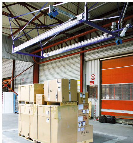
Deckenmodul Volumen, Bodenwaage eingebaut
